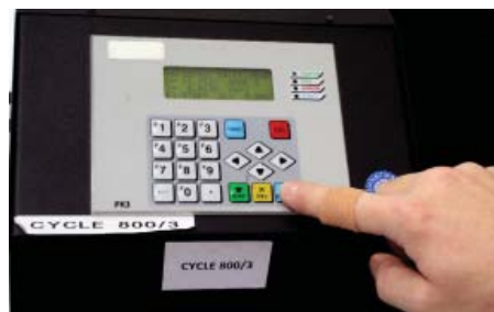
Préparation de l'ordinateur du test de batterie.
